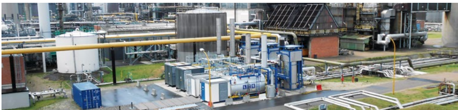
Installation de production vapeur surchauffée de 48t/h à 21barg et 320°C
