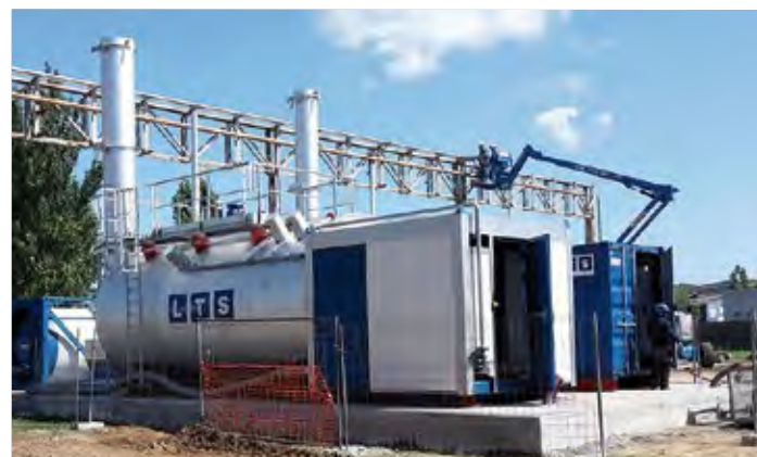
Mise en place de deux chaudières LTS sur le site de Solvay Blanes en Espagne
