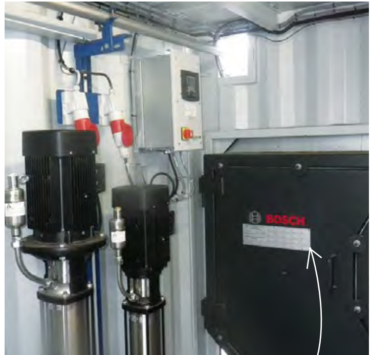
Gros plan sur la plaque de marque CE permettant de poinçonner à chaque CMS
